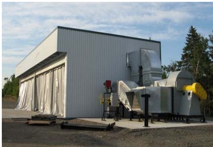
Photo du nouveau centre de conditionnement construit à l'été 2007. Picture of commercial dryer constructed in summer 2007.
